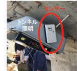
トンネル内附属物の異常監視センサー
