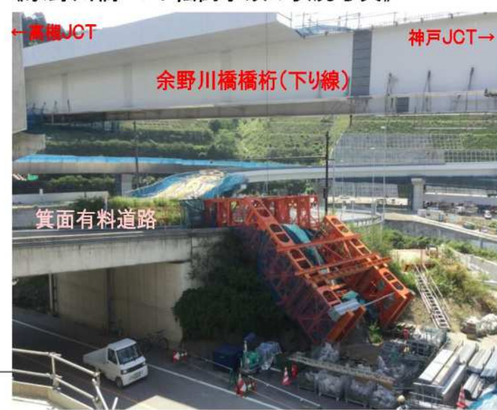
《余野川橋ベント転倒事故の状況写真》
