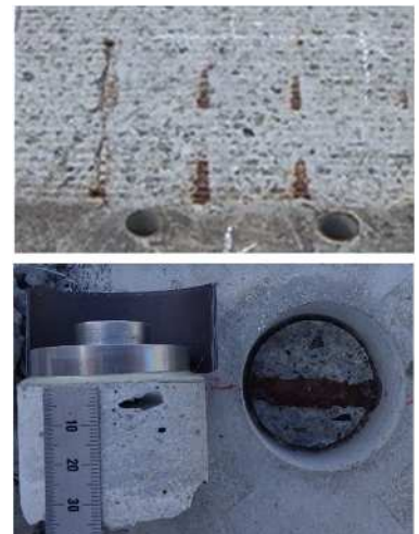
写真-7 増厚材鉄筋影響箇所
