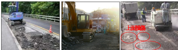
(a)舗装撤去 (b)切削作業 写真-1 舗装撤去および切削作業
