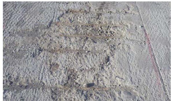
写真-1 RC床版上面劣化状況の一例
