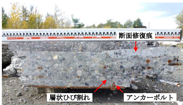
(d) 床版下面側コンクリートの層状ひび割れ
