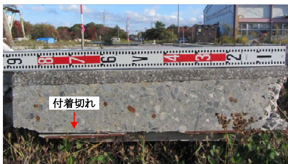
(a) 補強鋼板の付着切れ
