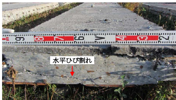
(b) 床版下面側コンクリートの水平ひび割れ
