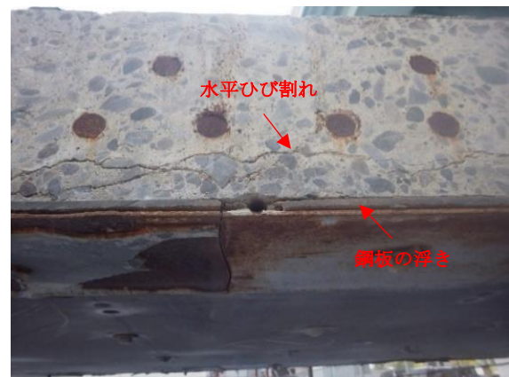
写真-1 RC 床版の水平ひび割れ，鋼板の浮き
