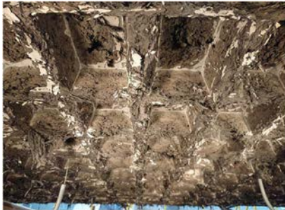
写真一 試験後の試験体状況
