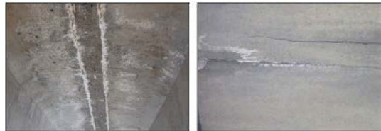
(b) PCT 桁間詰部 (c) 床版間の接合部 図-1 間詰部および接合面の損傷事例
