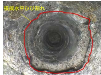
b) 水平ひび割れ
