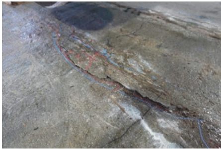
写真-5 塗布範囲の剥離と捲れ上がり
