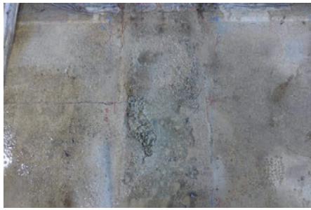
写真-4 未塗布範囲の土砂化状況
