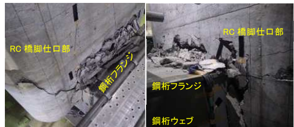
写真-1 試験体RC橋脚仕口部の破壊状況
