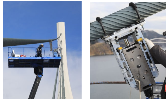
図-18 起振機によるケーブル減衰率の計測
