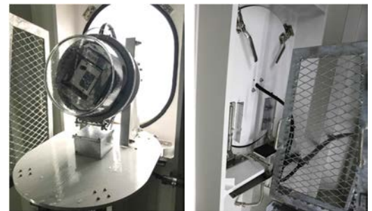
図-11 航空障害灯・開閉マンホール
