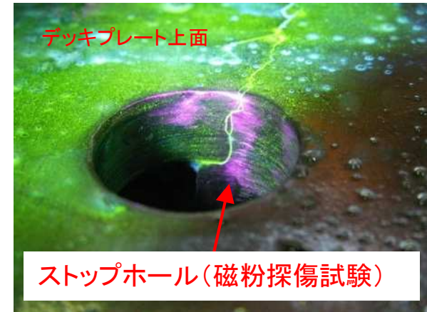
(g) 損傷事例
