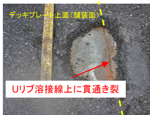
(e) 損傷事例
