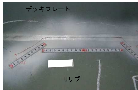
(c) 損傷事例
