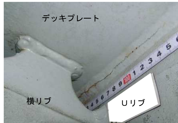
(a) 損傷事例
