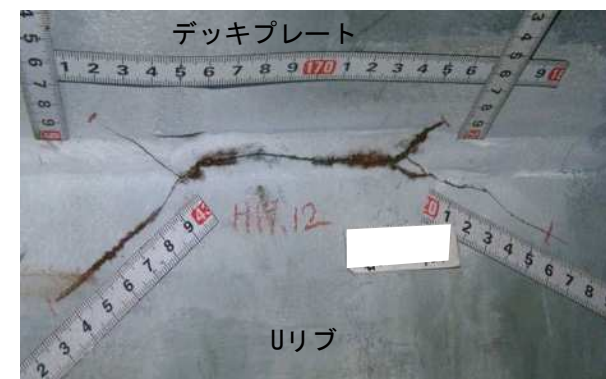
(d) 損傷事例
