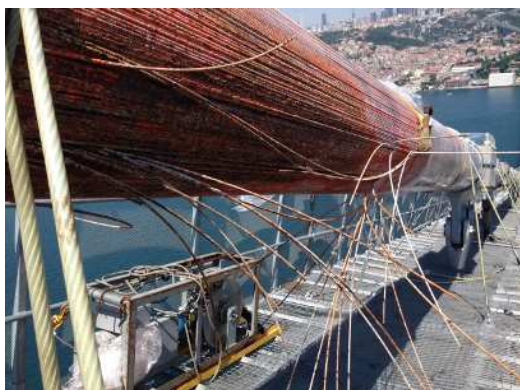
写真-12 塔頂の主ケーブル素線損傷状況
