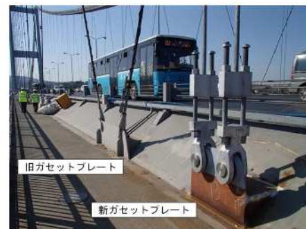
写真-2 新旧ガセットプレート
