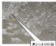
凍害によるひび割れ
