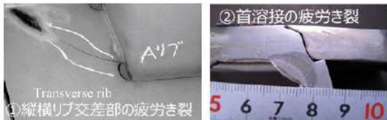
鋼床版に発生している主な疲労き裂
