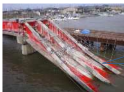
合成桁の撤去中の落橋事故事例
