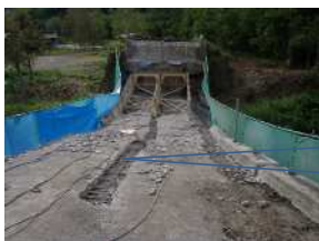
合成桁の撤去中の落橋事故事例
