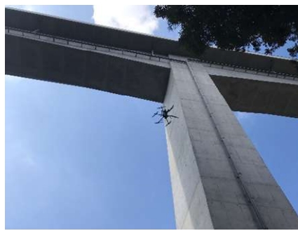
図一2 湯里高架橋現場検証
