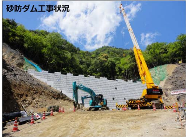
写真 4-1 被災状況とダム工事状況
