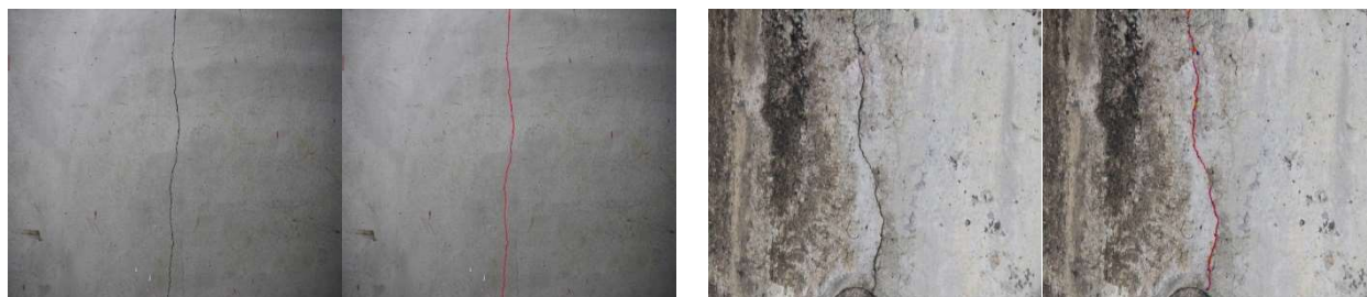
図－10 ひび割れ解析結果（赤で塗られている部分がひび割れとして検出された結果）
