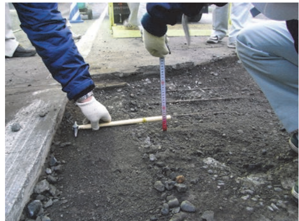
写真-1 寒冷地の道路橋床版の土砂化の事例
