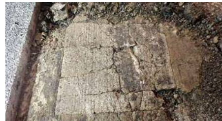
図-9 補修後の再劣化・補修材の割れ (中段写真は図-7と同位置で8年経過後)
