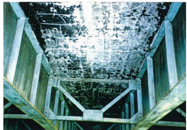
写真-2 補強前の床版下面の状況
