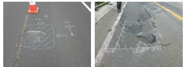
写真-1 舗装の変状の例
