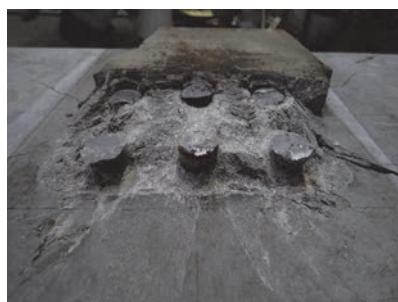
(b) G75-No.3 [左:コンクリート側, 右:鋼板側]
