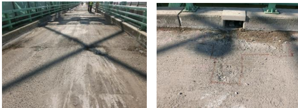
写真-12 床版上面損傷状況 (G橋)
