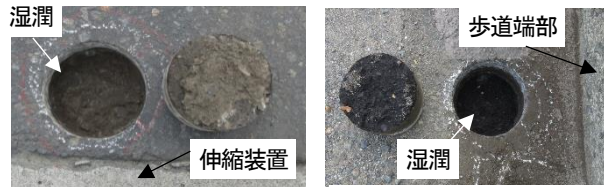
写真-10 コアの浸水状況 (No2)
