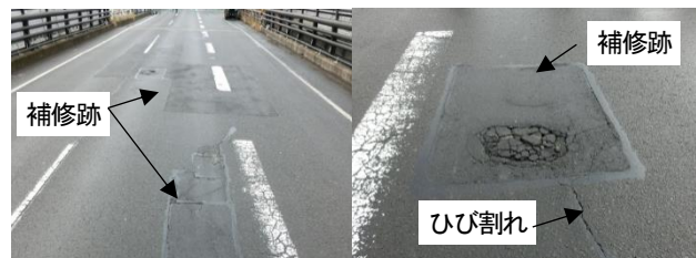
写真-13 路面の状況 (H橋)
