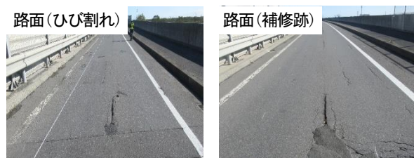
写真-1 路面の状況 (F 橋)
