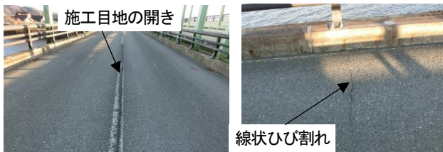
写真-18 路面の状況 (I橋)
