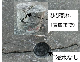
写真-6 施工打継目部のひび割れ状況 (No20)
