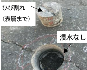
写真-7 ひび割れ直上のひび割れ状況 (No12)
