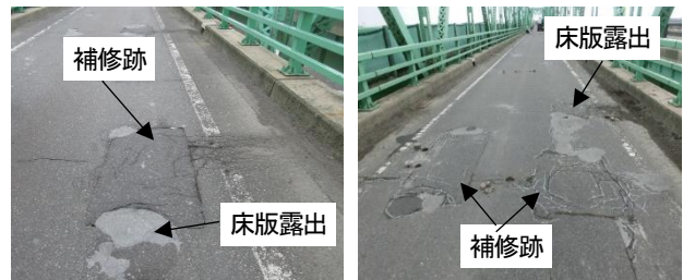
写真-9 路面の状況 (G 橋)
