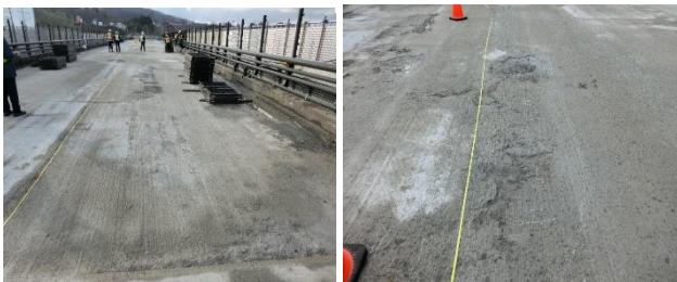
写真-16 床版上面損傷状況 (H橋)
