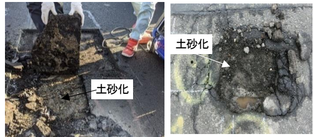
写真-17 舗装補修部下の床版損傷状況 (H橋)
