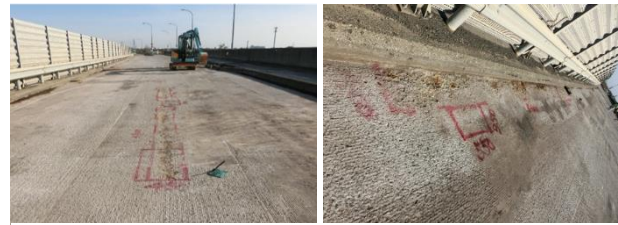
写真-8 床版上面の損傷状況
