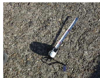
路面にひび割れはほぼ無いが骨材が露出し荒れている
