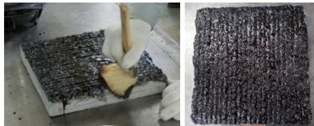
(a) 防水材塗布(刷毛) (b) 塗布完了 写真-4 防水材塗布状況 (塗布量 1.2kg/m 2 )
