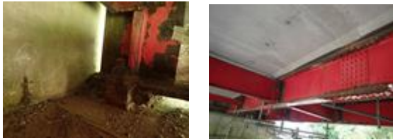
図-2 支承及び主桁の劣化状況
