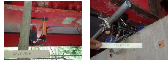
図-6 変位計設置状況 (左：鉛直変位，右：水平変位)
