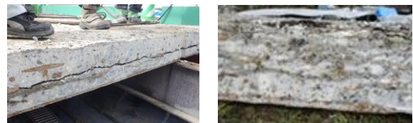
図-1 取り換え前床版の劣化状況
