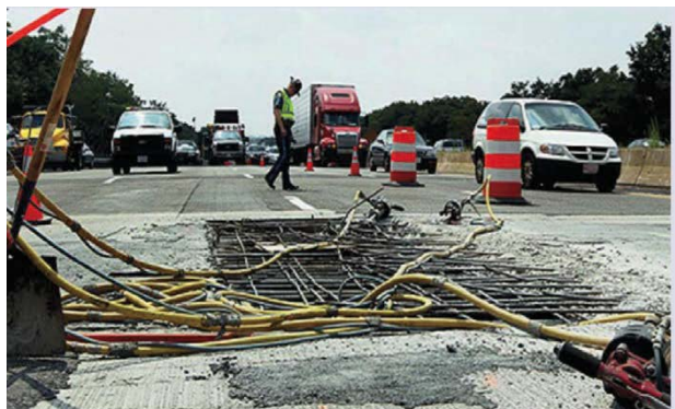
写真 3.4.14 床版陥没の状況 18)
