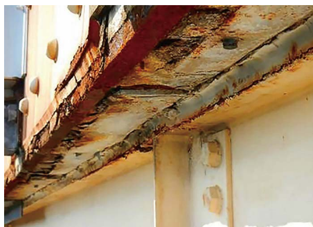
写真 3.3.3 壁高欄下面の劣化状況
