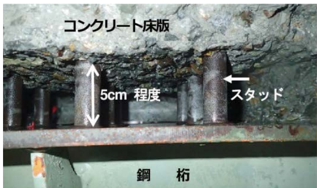
写真 3.1.11 ずれ止め露出状況
