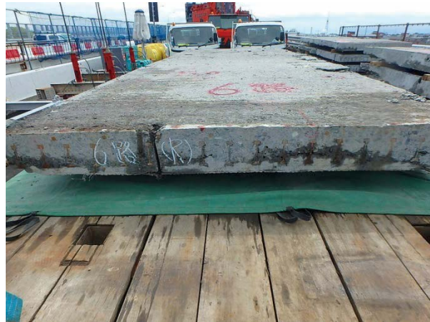
写真 3.3.4 既設床版切断面の劣化状況
