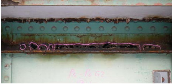
写真 3.2.1 鋼橋の腐食状況 1)を改変して転載
