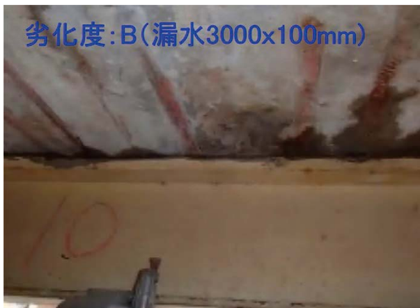
写真 3.3.2 床版下面の劣化状況
