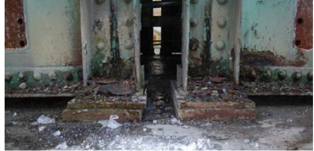
写真 3.2.2 支承部の劣化状況 1)を改変して転載
