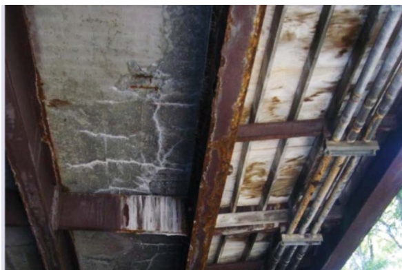
写真 3.4.13 プロジェクトの施工対象の劣化状況 18)
