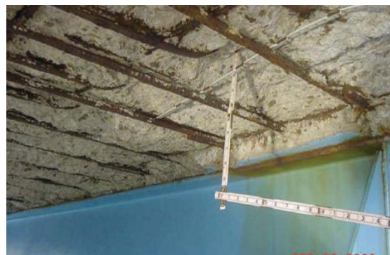
写真 3.4.26 橋梁床版の劣化状況 20)
