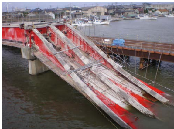
写真 2.1.1 銚子大橋の落橋事故の状況 3)
