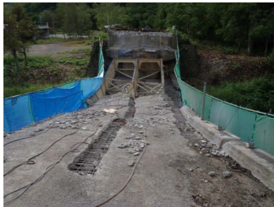
写真 2.1.2 月見橋の落橋事故の状況 5)
