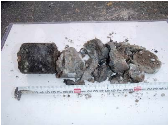
写真 1.3.1 防水層が設置されていない 床版から採取したコアの状況
