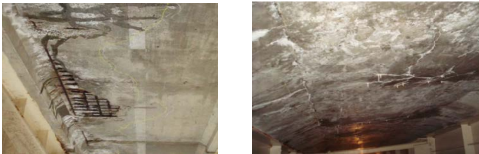
写真 1.4.2 凍結防止剤による塩害の加速期・劣化期の事例（RC 床版下面） 4)
