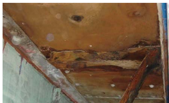
(b) 接着した鋼板の脱落
