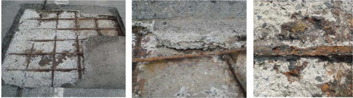
写真 1.4.1 凍結防止剤による塩害の加速期・劣化期の事例（RC 床版上面） 4)
