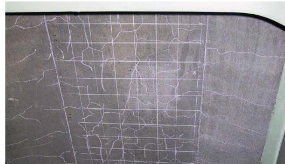
(b) 2方向のひび割れ
