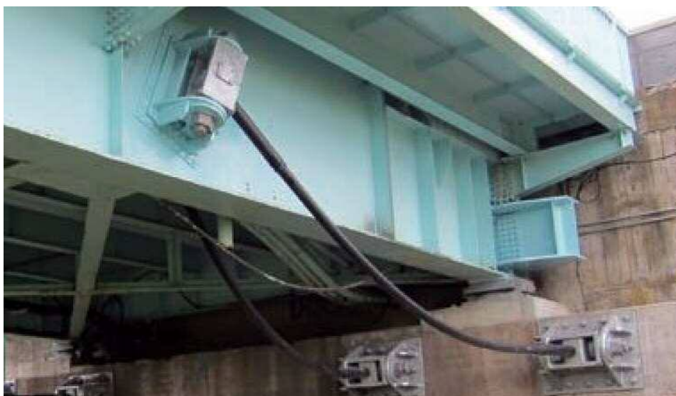
写真 2.6 落橋防止装置
