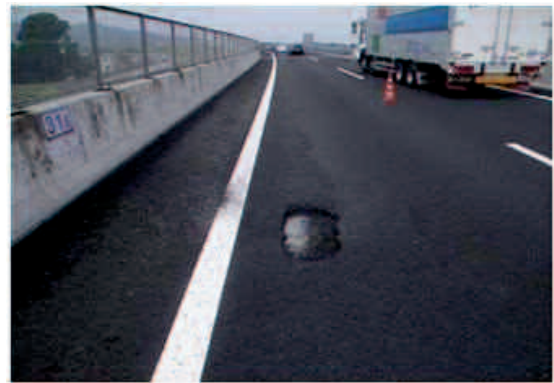
写真-1 橋面舗装の損傷例
