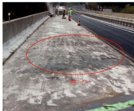
写真-6 舗装除去後の残存タックコート
