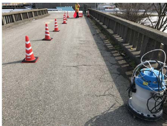
写真-4 興人橋の路面状況
