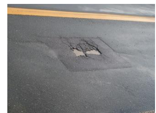
写真-1 ポットホール
