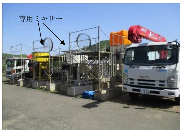
写真-5 練混ぜプラント
