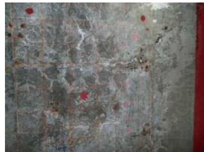
写真-4 変状部の状況
