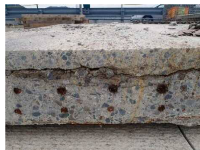
写真-5 変状部の状況
