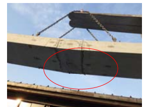
図-23 1点曲げ試験破壊状況 （継手あり）
