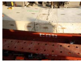
図-25 1点曲げ試験破壊状況 (継手あり)
