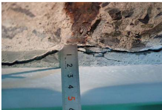
写真 - 2 損傷部②(近景)
