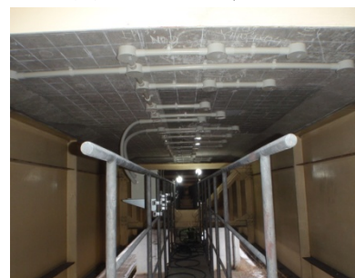
写真-9 配線・配管状況
