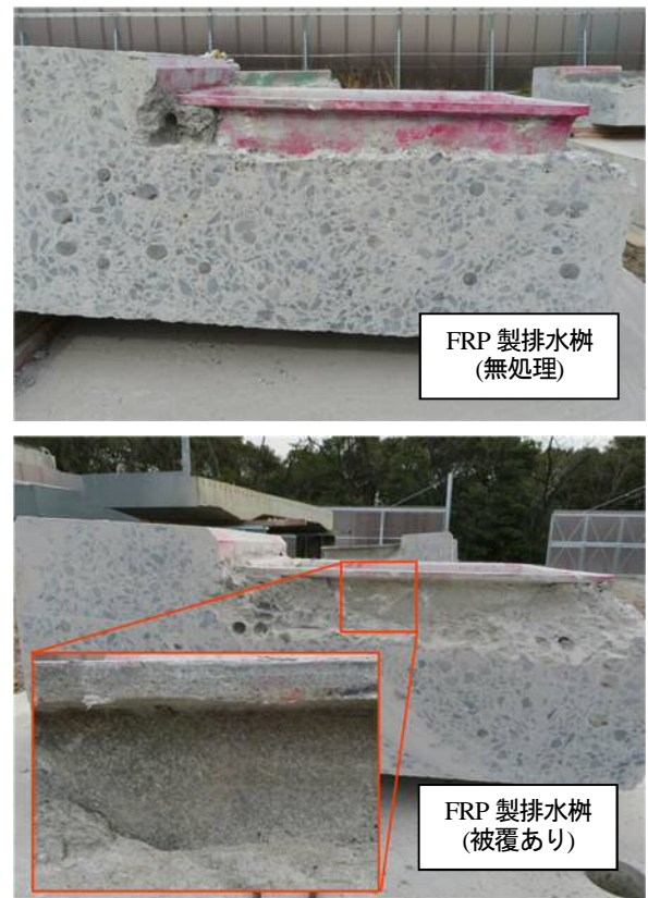
図-9 FRP 製排水樹の状況
