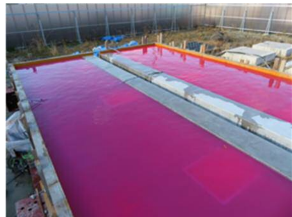
図-7 色水による湛水状況
