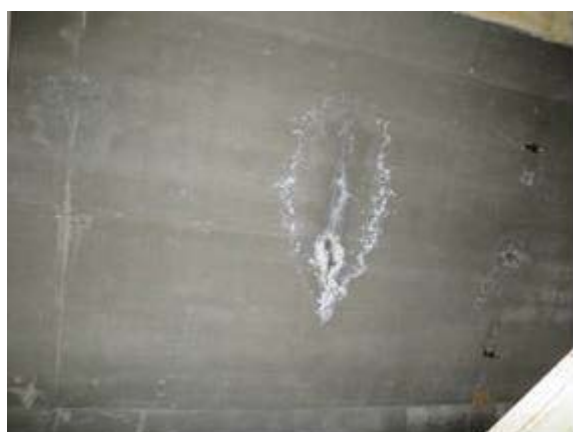
写真-1 床版下面のひび割れと白色析出物
