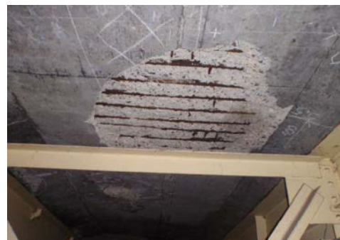
(1)床版下面かぶりコンクリートはく落状況
