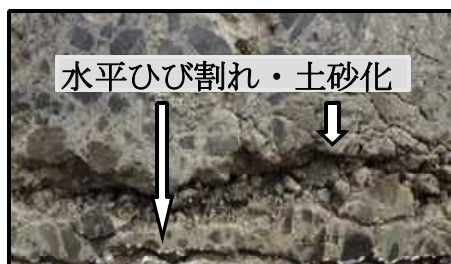
(1) 水平ひび割れと土砂化
