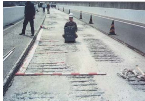
写真-1 鋼橋RC床版上面の水による疲労・劣化状況(雄の山橋, 劣化箇所が、点在している)
