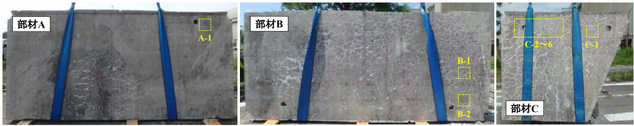
図一 床版下面の変状状況とコア採取位置
