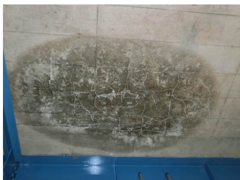
写真-2 床版下面ひびわれ・遊離石灰状況
