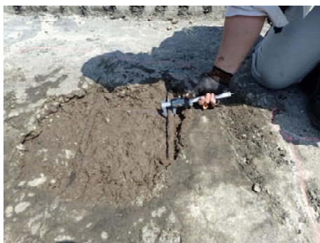
写真-6 土砂化調査状況
