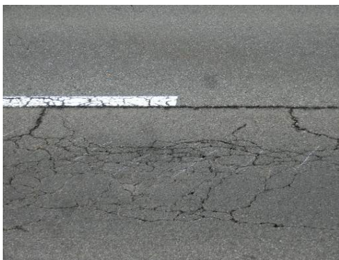
写真-1 橋面舗装ひびわれ状況
