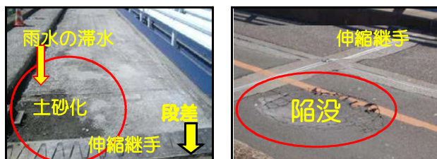
(1) 土砂化 (2) 陥没 8) 写真-1 伸縮継手付近の損傷状況
