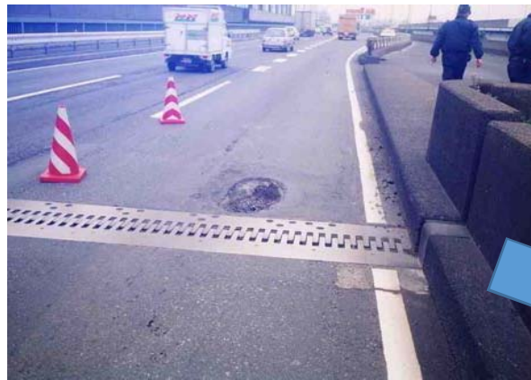
舗装に生じた変状
