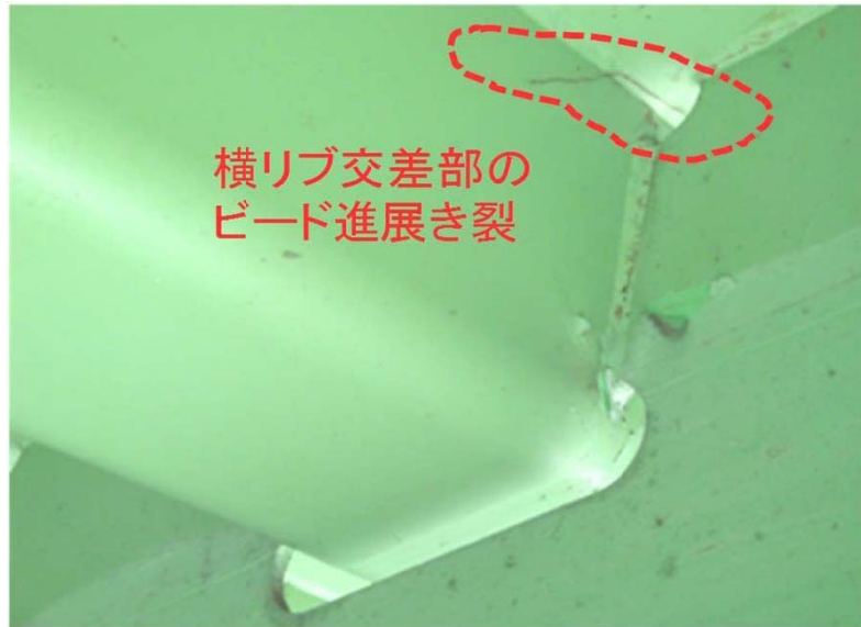
横リブ交差部のき裂
