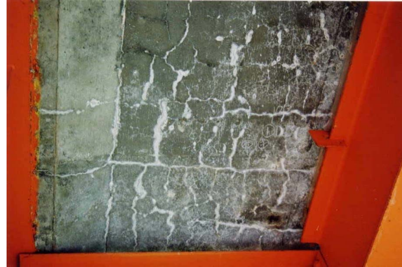
格子状ひび割れへの移行
