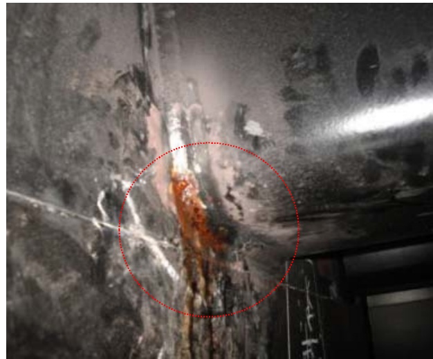
き裂部からの漏水 (Uリブ内の滞水が疑われる。)
