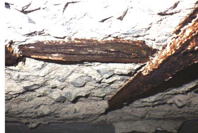
鉄筋の腐食状況
