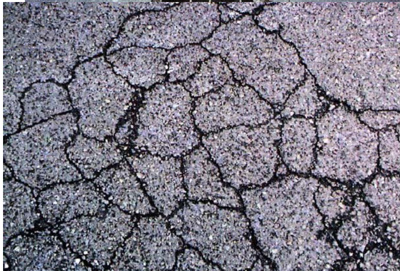
抜け落ち前の舗装の状況
