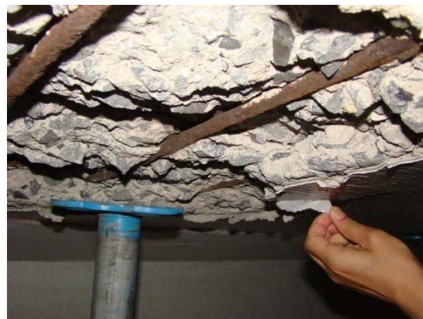
剥落した下面の状況
