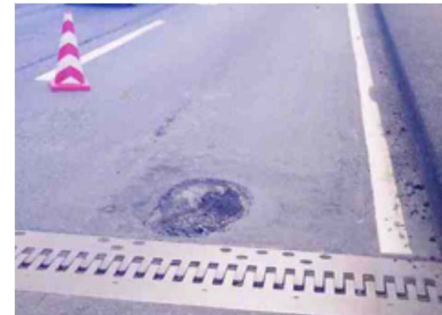
亀裂上の舗装に生じた変状
