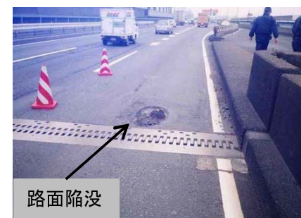
舗装に生じた変状
