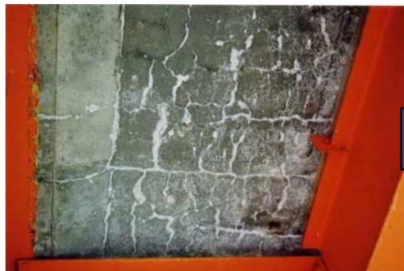
2方向のひび割れ
