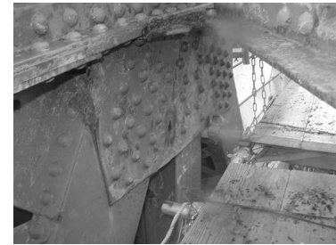
図-7 腐食劣化の例
