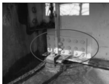
(当て板補修後)
