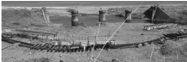
耐力の階層化 (JSSC土木鋼構造物の点検・診断・対策技術 2017年度版)
