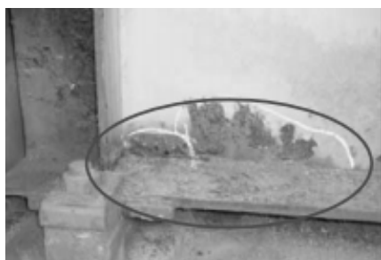
(腐食により一部断面欠損)
