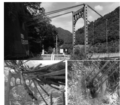
写真-8 橋全体系の崩壊につながる部材
